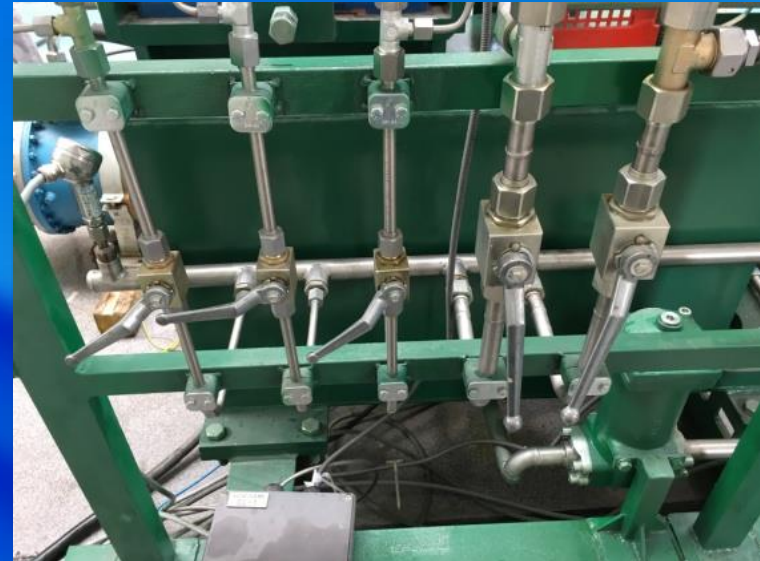
Rampa de ungere și injecție cu ulei
